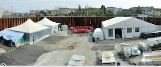
Il cantiere di scavo delle Navi Antiche di Pisa nei pressi della stazione di San Rossore (Antonacci, 2015)
